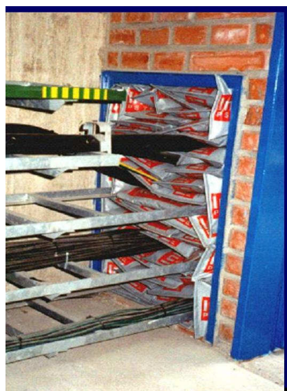
Attraversamenti di servizi tecnici
